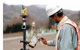
プリズムがついた計測ポールを立てるだけで、その地点をTSが出来形測定を行う
